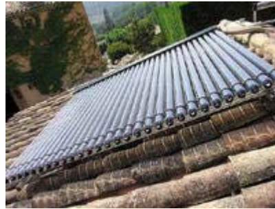
Les chauffe-eau solaires à capteurs sous vides existent au Maroc en version individuelle et collective./DR
